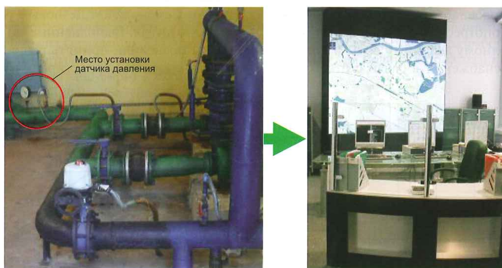
Рис. 4. Установленный на повысительной водопроводной насосной станции датчик давления с передачей данных в Центральную диспетчерскую службу
