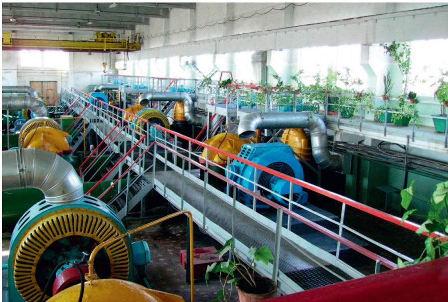
Рис. 2. Машинный зал насосной станции НС-5
