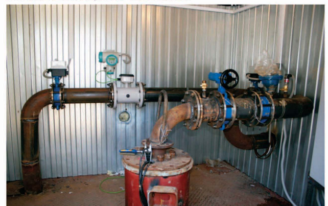
Рис.18. Оборудование внутри помещения скважины
