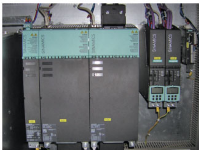
Рис. 11 Преобразователи частоты, установленные в электропомещении современного штыревого крана
