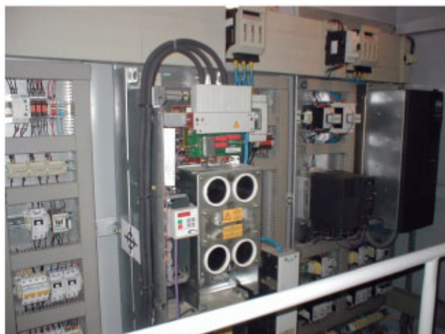
Рис. 19 Электропомещение внутренней монтаж
